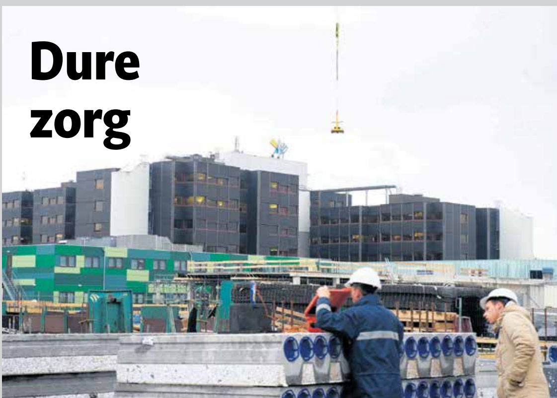
Het Medisch Spectrum Twente is deze week begonnen met de nieuwbouw. Daar wordt 400 miljoen euro voor uitgetrokken.
